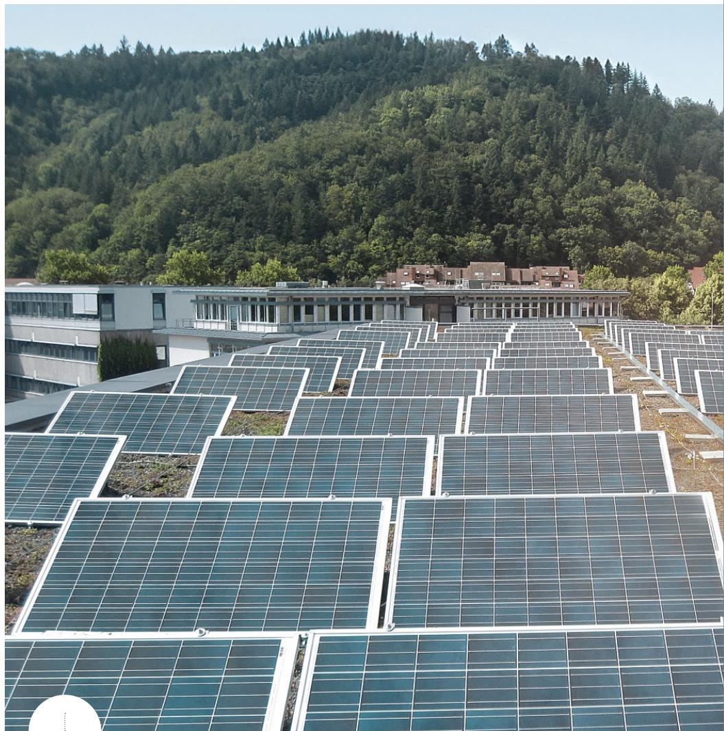
Sichtbarer Ausdruck der Umweltstrategie: Solarmodule am Standort Waldkirch.
